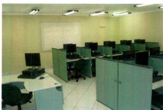
Supervisão/Central de Processamento de Dados
